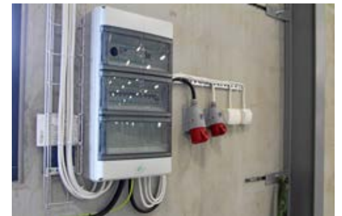
Elskåpet, som bland annat rymmer styrning av belysningen på tidur. Sensorer och rörelsevakt tändar och släcker när man kommer in och lämnar hallen.
